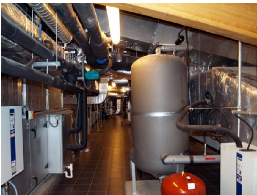
Urządzenia klimatyzacyjno-wentylacyjne – III p.
